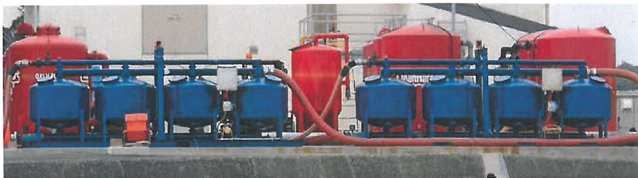
青いタンクが新たに設置されていた(2023年7月9日)
