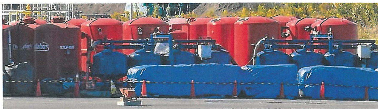
フィルターからのホースが取り外されていた(2023年10月22日)
