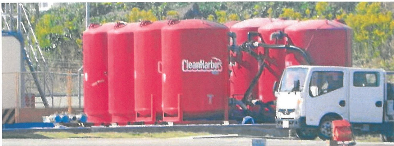
活性炭フィルター稼働直前(2022年10月23日)
